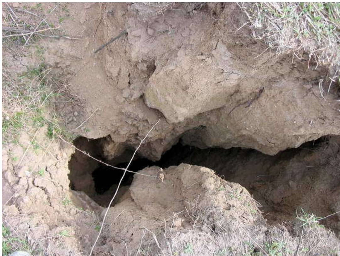
Fig. 12. Jedna z głębszych szczelin w glinach zwałowych powyżej krawędzi osuwiska.
